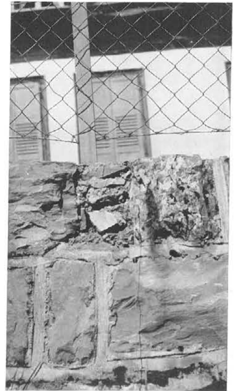
Abb. 172, Seite 96 Zaunpfosten, unfachmännisch eingemauert
