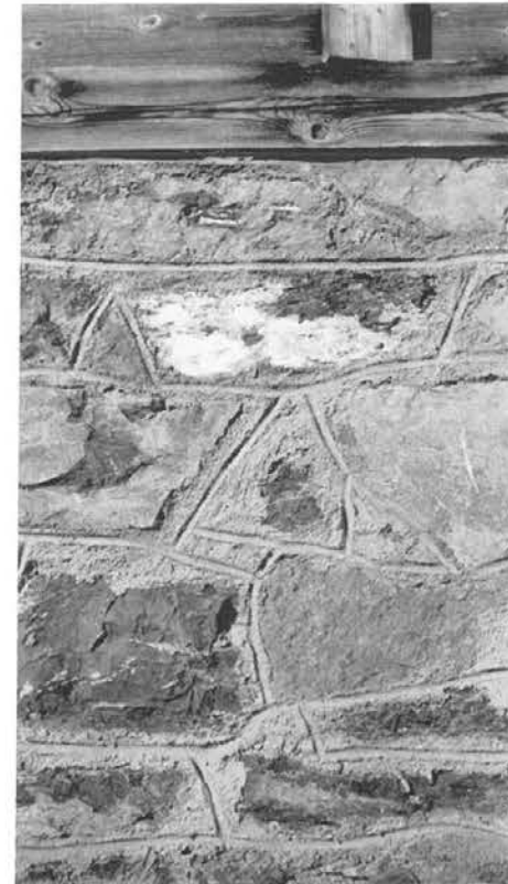
Abb. 151, Seite 94 Die Fugen sind unnatürlich gezogen
