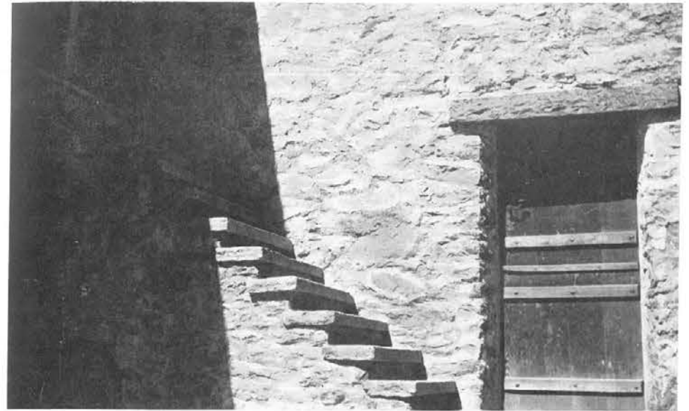
Abb. 239, Seite 116 Die Trittplatten sind zu wenig eingemauert
