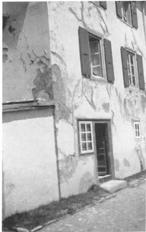
Abb. 141, Seite 92 Abgebröckelter Verputz, schlechtes Material
