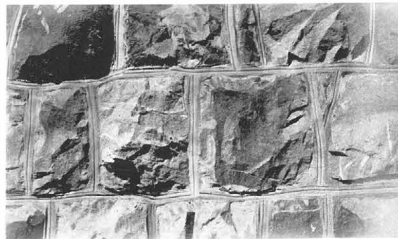
Abb. 158, Seite 95 Fassadenverkleidung (Steine zu quadra- tisch, Fugen zu künst- lerisch gezogen)
