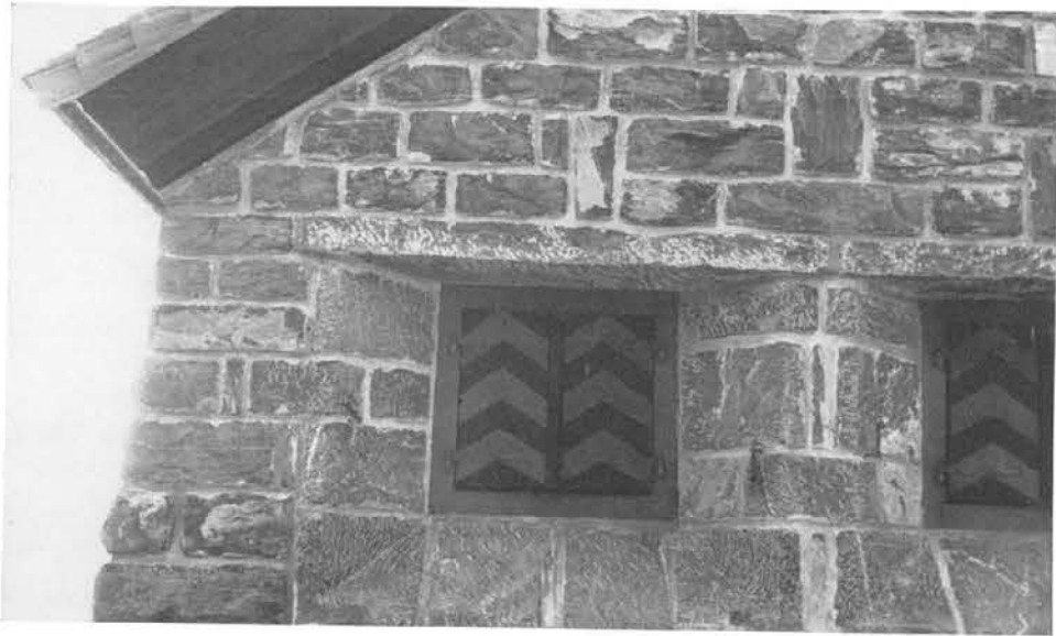
Abb. 220 und 221, Seite 113 Die Spitzisenstreiche stören das Gesamtbild dieses Mauerwerkes
