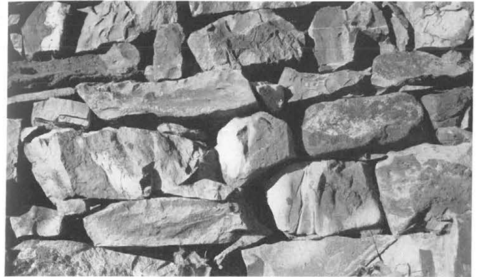
Abb. 202, Seite 110 Handwerklich schlechte Arbeiten
