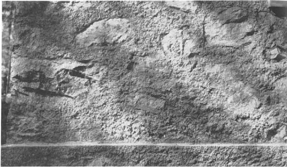
Abb. 149, Seite 94 Fugen mit Mörtel überbordet
