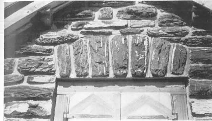
Abb. 227, Seite 113 Der Sturz einer Holzzarge durch einen Steinsturz entlastet
