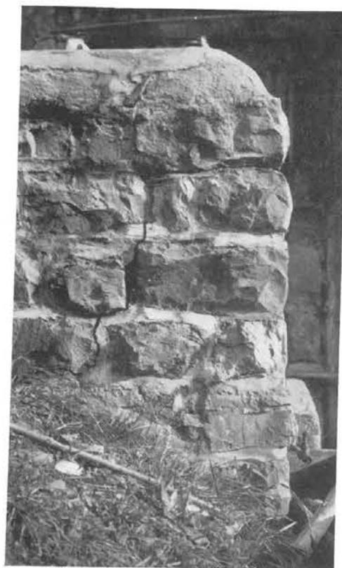
Abb. 192, Seite 108 Freistehende Mauern sollten immer unter die Frostzone fundiert sein (siehe entstandener Riß)
