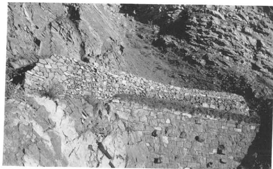
Abb. 303, Seite 124 Stark eingebaute Trockenmauer
