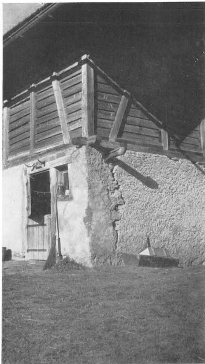
Abb. 194, Seite 108 Reparaturarbeiten in solchen Fällen sehr schwierig
