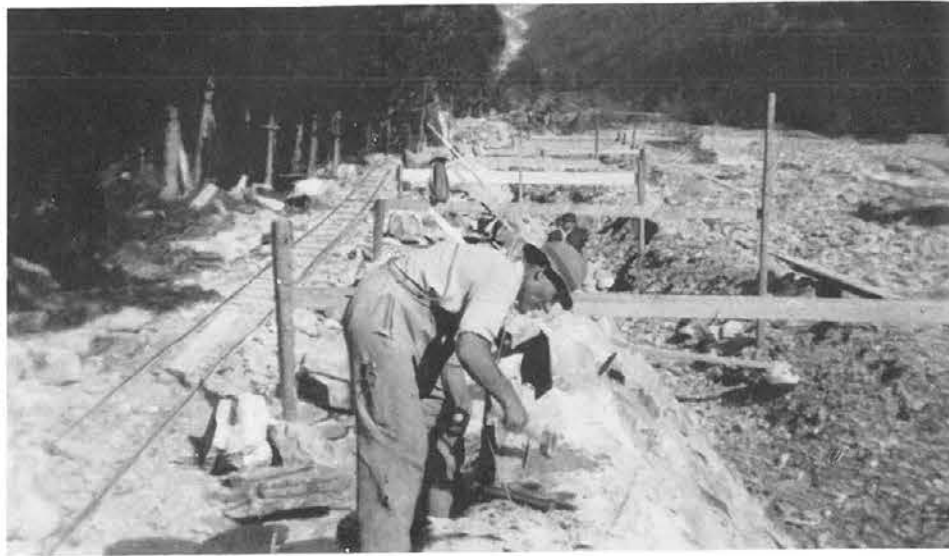
Abb. 56, Seite 50 Anlage eines Schrägaufzuges
