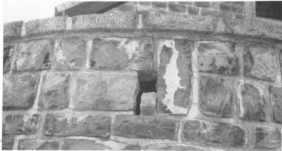
Abb. 247, Seite 116 Typischer Konstruktionsfehler
