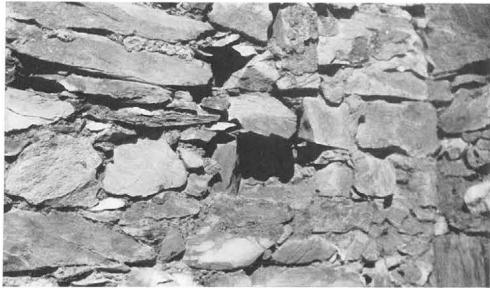
Abb. 186, Seite 108 Glatte Steinköpfe, schlechte Haftung des Putzmörtels, sollte ein Verputz in Frage kommen
