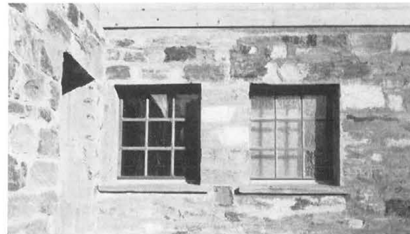
Abb. 229, Seite 114 Die Fensterbänke weisen zu wenig Gefälle auf
