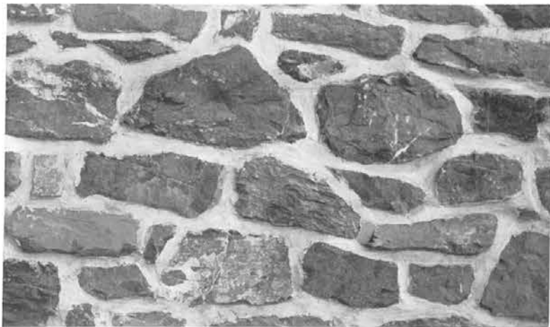
Abb. 153, Seite 94 Mörtel nicht verarbeitet
