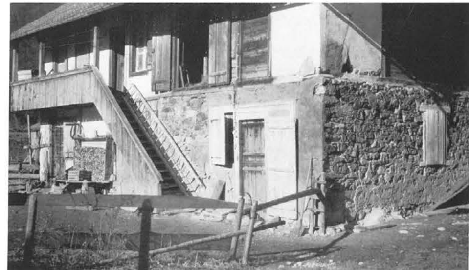
Abb. 129, Seite 88 Aus ästhetischen und praktischen Gründen kommt ein neuer Verputz nicht in Frage. Lösung: Restlichen Verputz abhacken, Fugen ausputzen und mit Mischgut 1 : 4 sauber ausfugen
